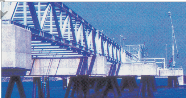
ALUNODE로 방식되는 잔교부두파일 Jetty Steel Piles Protected by ALUNODES
