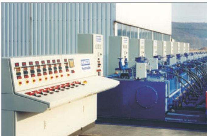
Antriebs- und Steuerungstechnik für Staudamm Wujiang Xi, China
